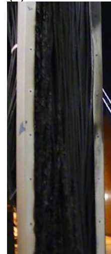
(d) Vertical Duct
