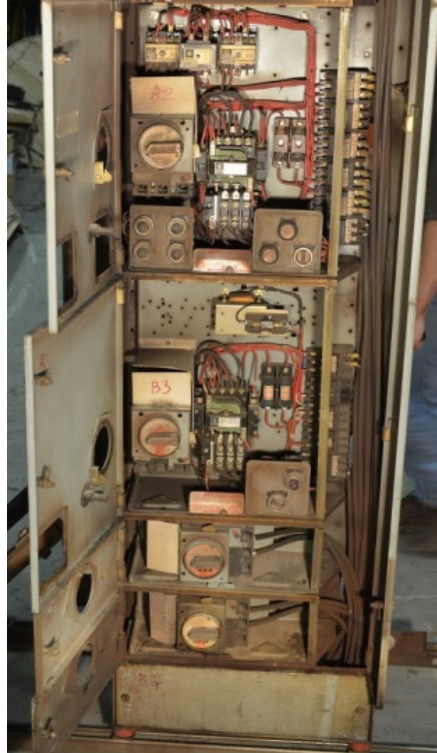
(b) No cable fire
