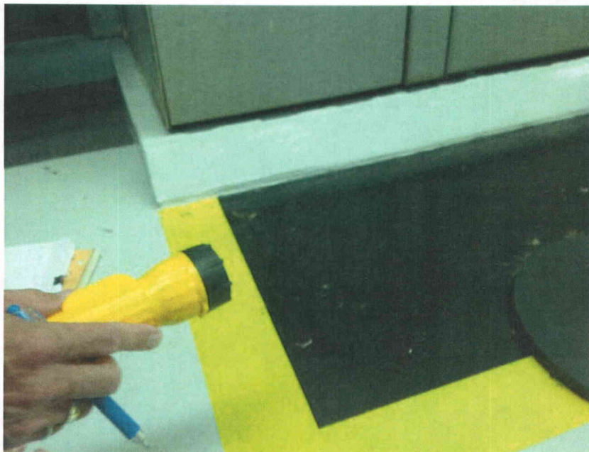
F1 anchorage inaccessible
