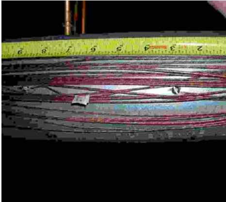
#7: TCs on conduit.
