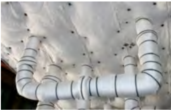
#105: Conduit 1C hot.
