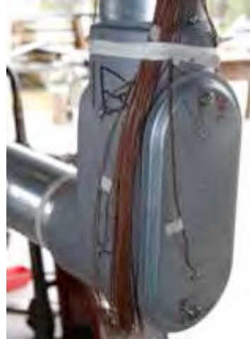
#8: LB on conduit 1B.
