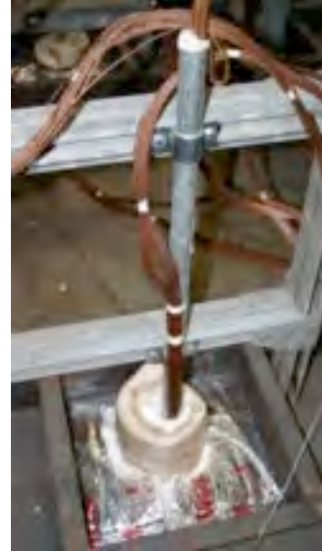
#92: Top side, conduit 1F.
