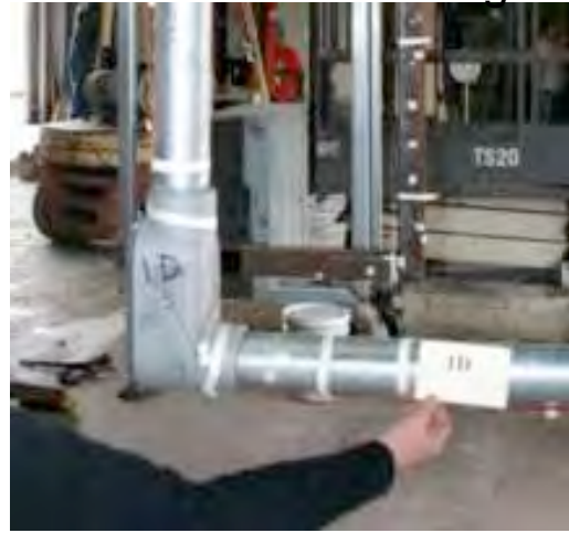
#14: LB on conduit 1D.
