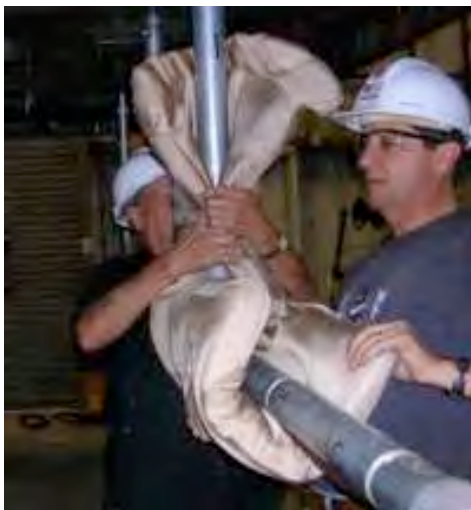
#35: Cladding LB on conduit 1C.
