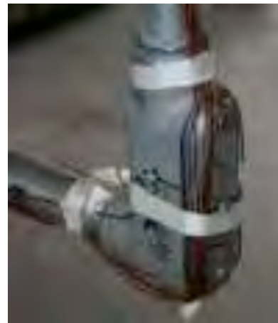
#18: LB on conduit 1E.
