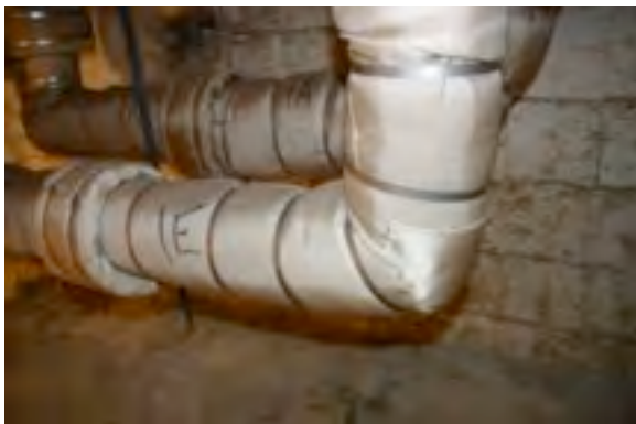
#83: Furnace TC next to conduit E.
