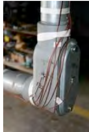
#16: LB on conduit 1D.
