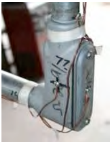
#11: LB on conduit 1F.
