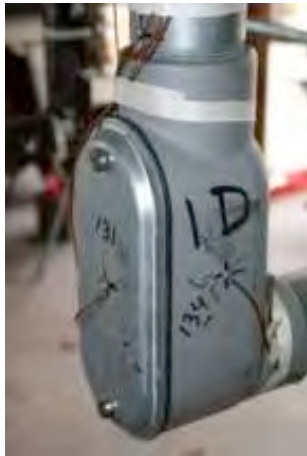
#15: LB on conduit 1D.
