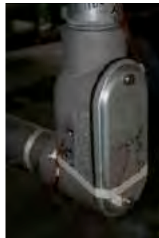
#12: LB on conduit 1C.
