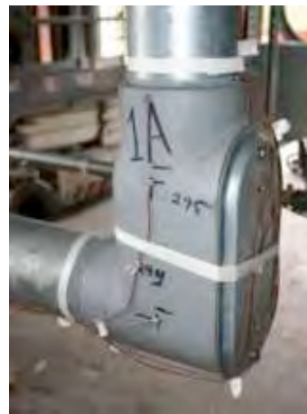
#4: LB on conduit 1A.
