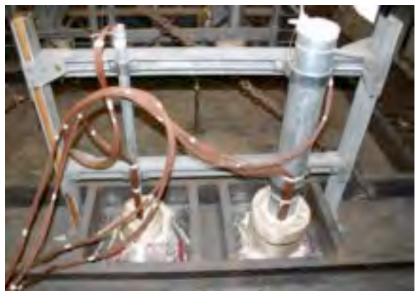
#90: Top side, conduits 1F & 1B.
