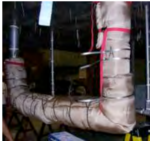
#30: Cladding conduit 1A.
