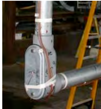
#10: LB on conduit 1C.
