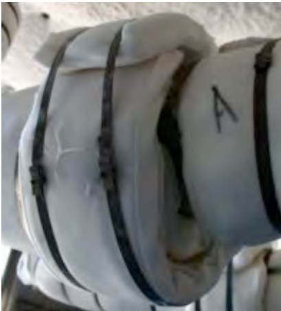
#135: Conduit 1A gap.
