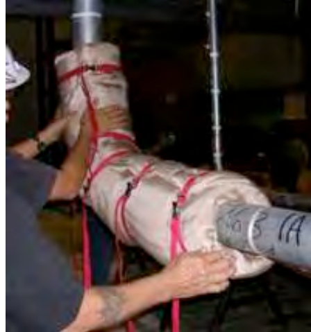
#56: Cladding conduit 1A.
