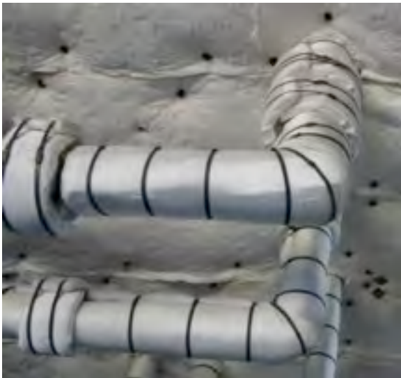
#101: Gap in conduit 1A.
