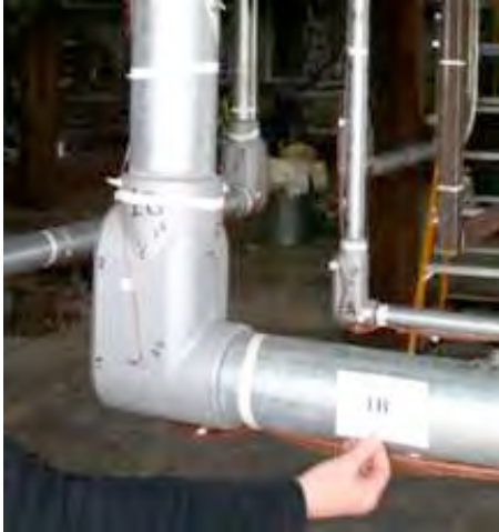
#7: LB on conduit 1B.
