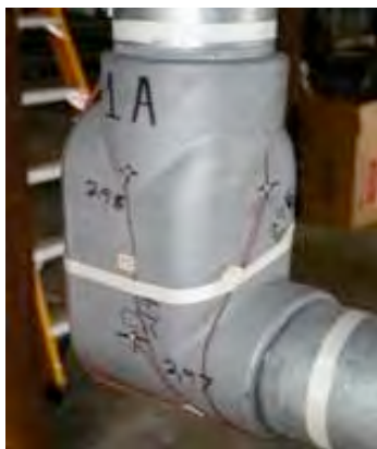
#5: LB on conduit 1A.
